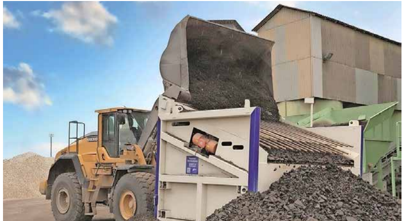
Beschickung der SBR 4 – jederzeit dank Sensorsteuerung
